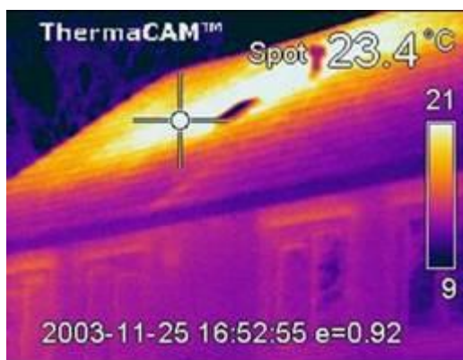
Figuur 35: groot warmteverlies op het dak
